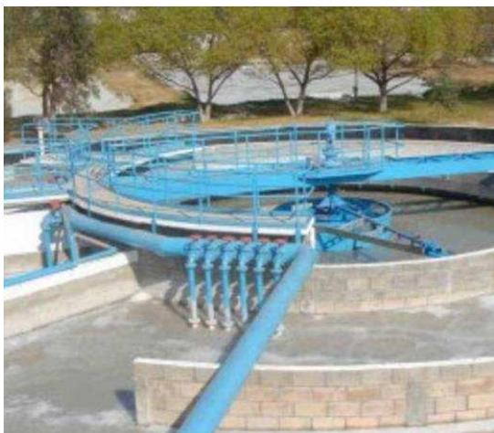
Ilustración 10. Planta de tratamiento
