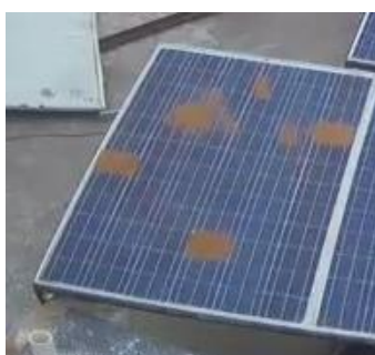
Figura 3: Imagen panel fotovoltaico
