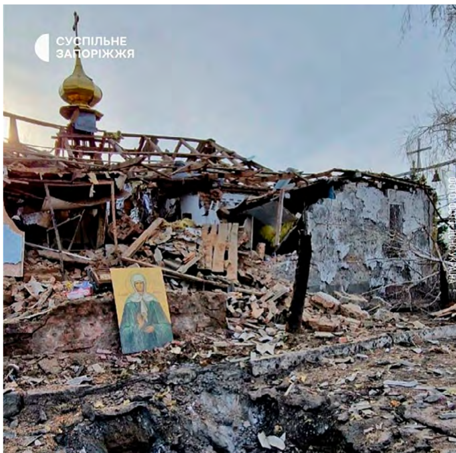
Figura 2. Una iglesia ortodoxa de la región de Zaporizhzhia, bombardeada en la noche de Pascua. Servicio de estado de emergencia de Ucrania.
