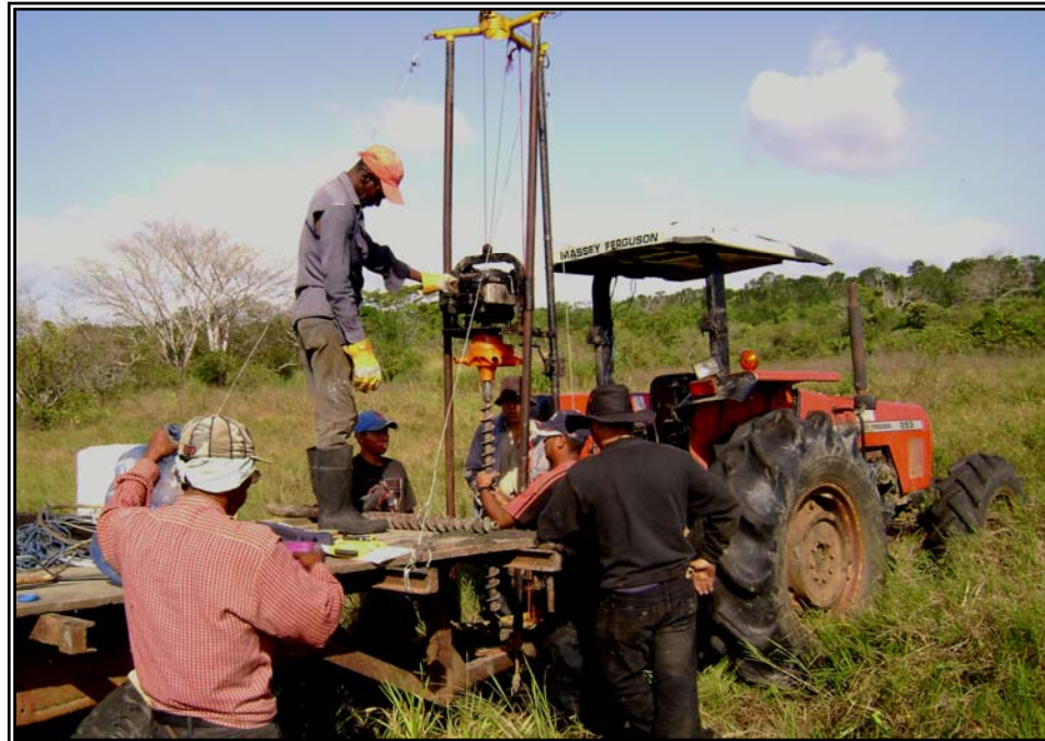
Figura No. 3-3 Equipo de perforación utilizado para la prospección de los bancos de arena. Plataforma de perforación improvisada, montada sobre el tractor
