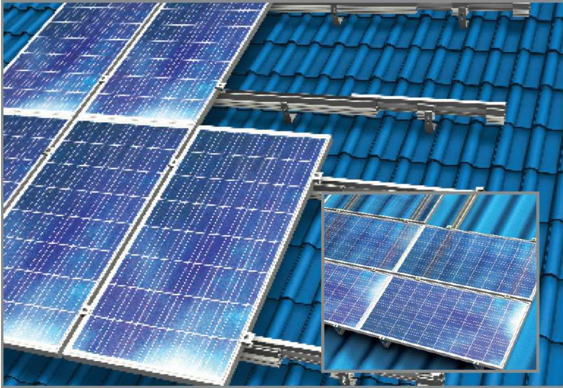
Figura 17: Imagen de módulos fotovoltaicos sobre la estructura de soporte.
