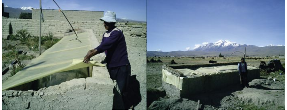
Biodigestores instalados en altiplano, cerca del lago Titicaca
