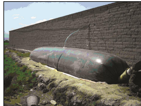
Figura 25. Sistema de biodigestión anaerobia utilizada
