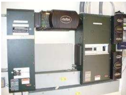
Imagen: El panel principal. El inversor es la caja de del tamaño de una caja de zapatos que hay entre los dos grandes paneles, los controladores de carga (uno para la matriz y uno para la pila de combustible) se encuentran en el extremo derecho.
