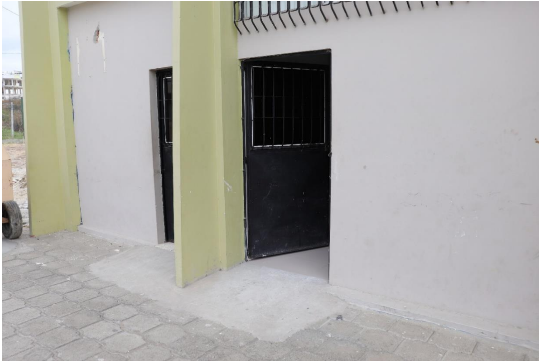
Rampa de acceso inclusiva a las oficinas del rectorado
