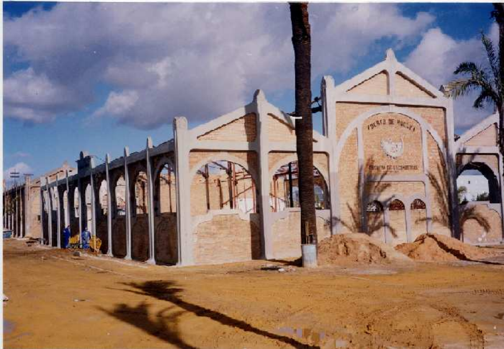
Restauración de los edificios de las Cocheras de Locomotoras y del Almacén General del Puerto (Foto AAPH)
